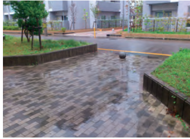
一般的な非透水ブロック舗装。雨水で路面が水浸しに。
